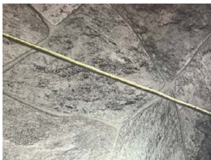
Sveis mangler i skjøt av gulvbelegg
