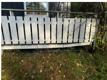
Dels store skjevheter grunnet sviktende fundamentering
