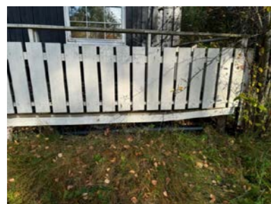
Dels store skjevheter grunnet sviktende fundamentering
