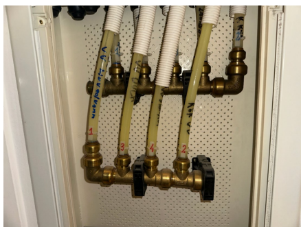
Samleskap for vannrør
