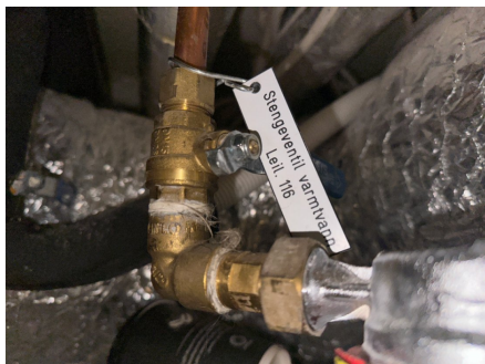
Stoppekraner plassert i felles gang
