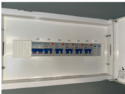
Sikringsskap med automatsikringer.
