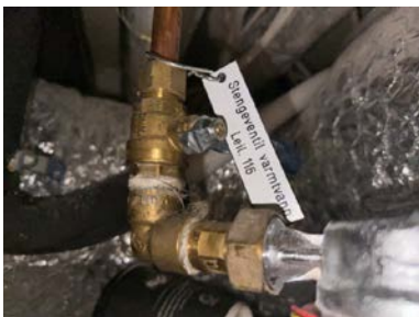
Stoppekraner plassert i felles gang
