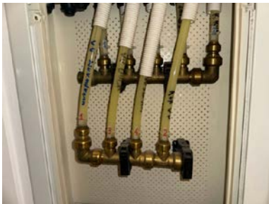
Samleskap for vannrør
