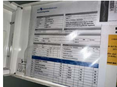
Kursoversikt i sikringsskap
