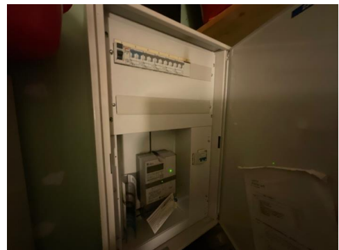
Sikringsskap i boden
