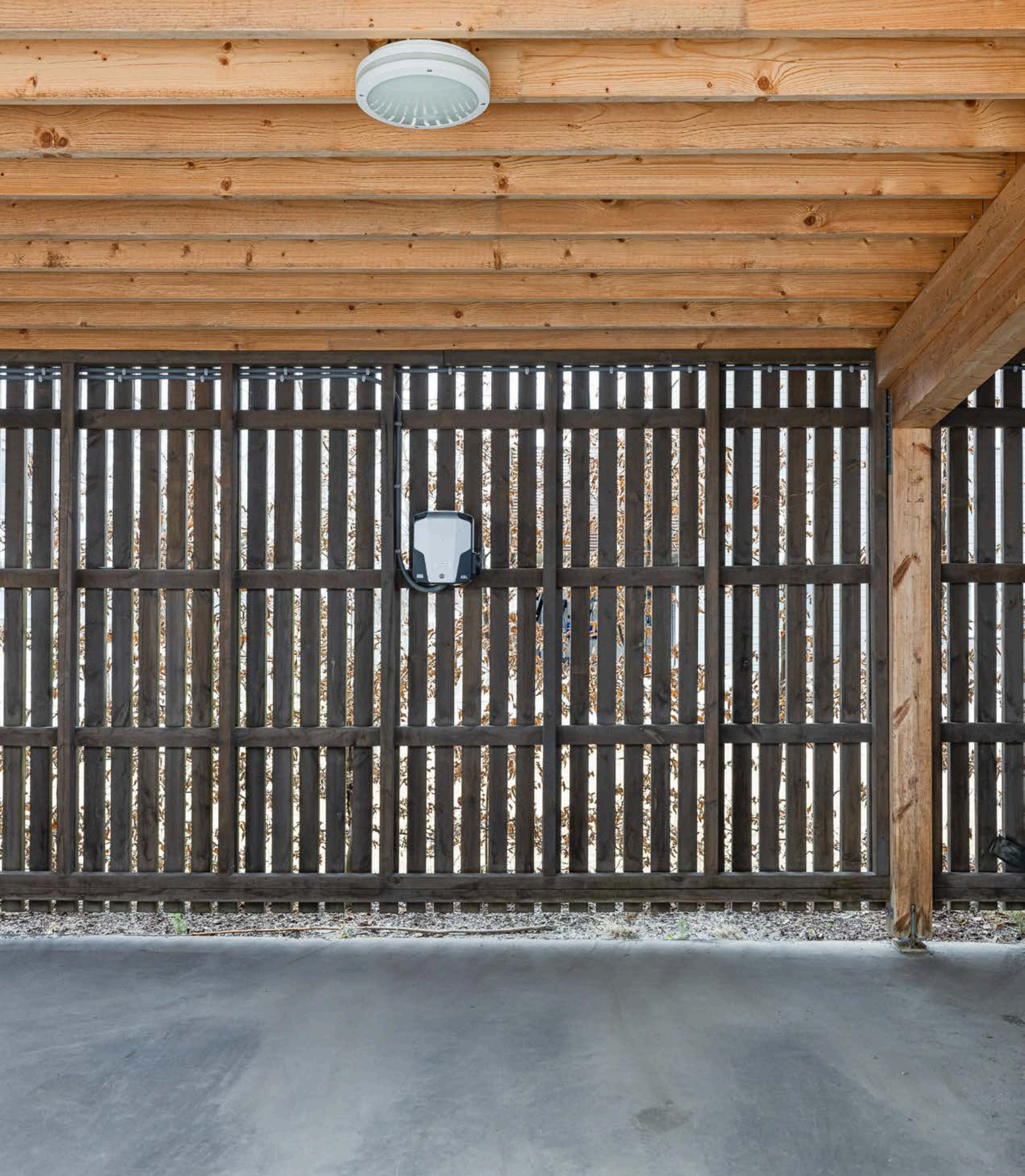
Plass i felles carportanlegg hvor det er montert elbil-lader.
