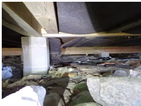
Stubbloftsplater som har falt ned.
