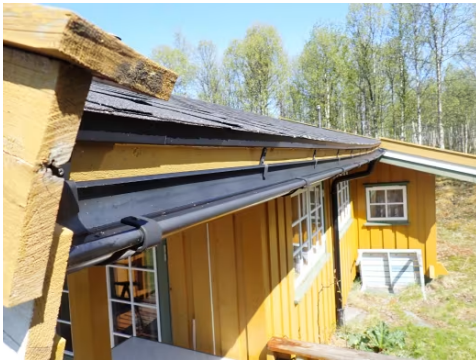
Tydelig svank/skjevhet langs takfot.
