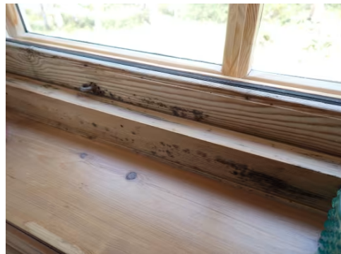
Sverting i baderomsvindu.
