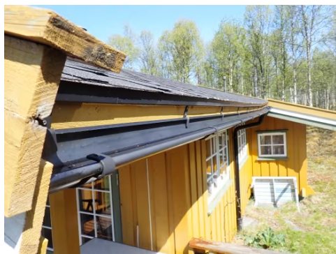
Tydelig svank/skjevhet langs takfot.
