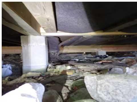
Stubbloftsplater som har falt ned.
