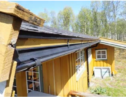
Tydelig svank/skjevhet langs takfot.
