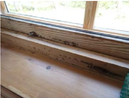
Sverting i baderomsvindu.
