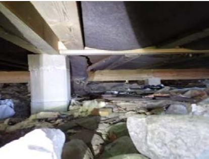
Stubbloftsplater som har falt ned.
