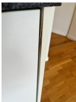
Fuktsvelling på skapskrog ved oppvaskmaskin
