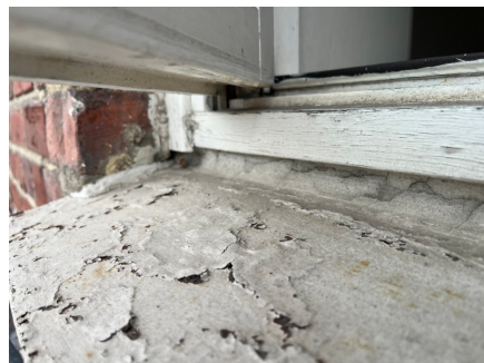
Utvendig slitt overflate
