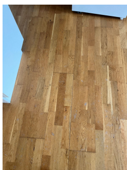
Slitasje gulv foran kjøkkeninnredning
