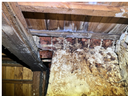
Fuktmerker i bordtro nedenfor pipe.
