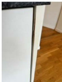
Fuktsvelling på skapskrog ved oppvaskmaskin
