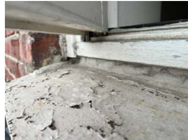
Utvendig slitt overflate
