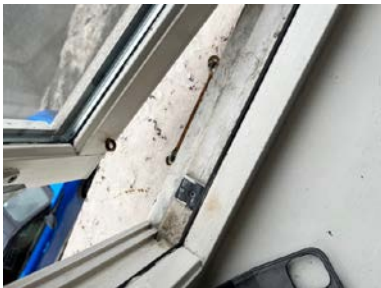
Slitt overflate i karm og noe merker etter kondensvann på glass ramme
