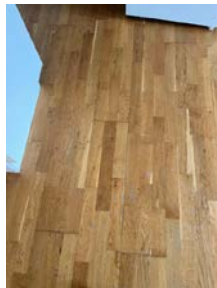
Slitasje gulv foran kjøkkeninnredning
