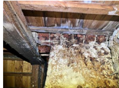
Fuktmerker i bordtro nedenfor pipe.
