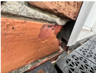
Det mangler en liten bit av teglstein i vegg ved døren,
