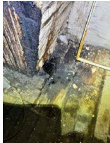
Fuktmerker på gulv på kaldloft og fukt på pipe
