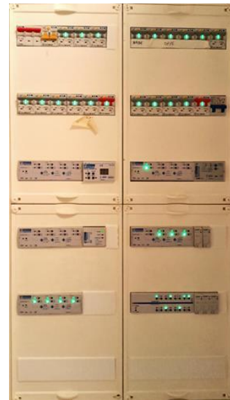
Elektrisk anlegg - [Sikringsskap]
