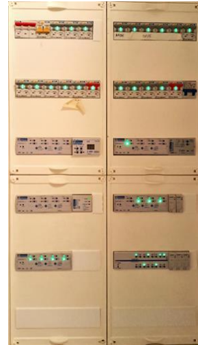
Elektrisk anlegg - [Sikringsskap]
