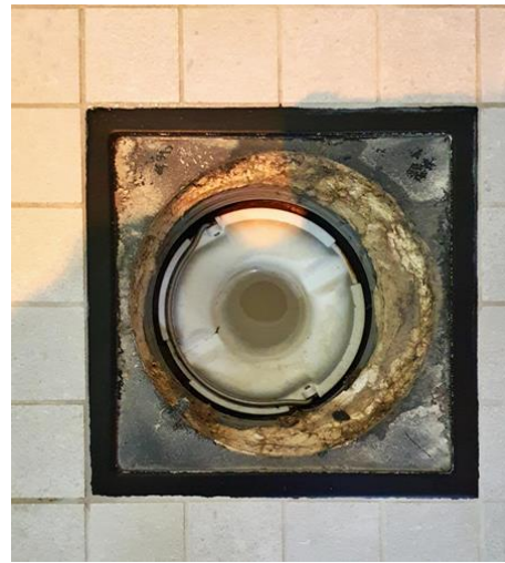
Våtrom - [Bad 1. etasje]
