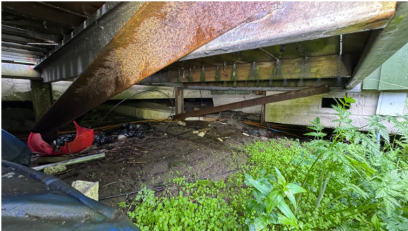
Skråavstiving på terrassen er løsnet.
