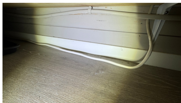
Kabler er ikke tilfredsstillende festet (TG3).
