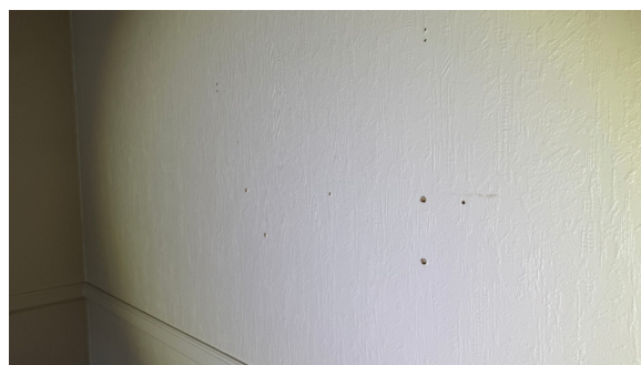
Det er en del skruerull i enkelte vegger.
