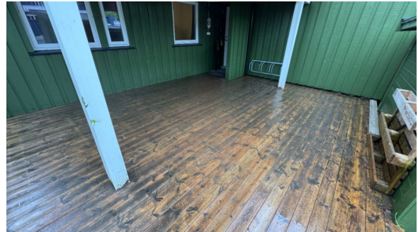
Terrasser er værslitt.
