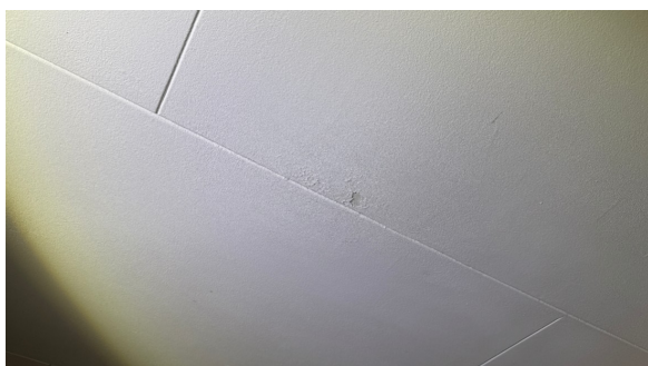
Avflassing av maling på takplater.
