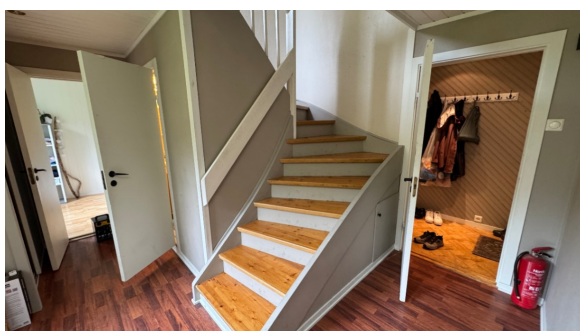
Trappen mangler rekkverk.
