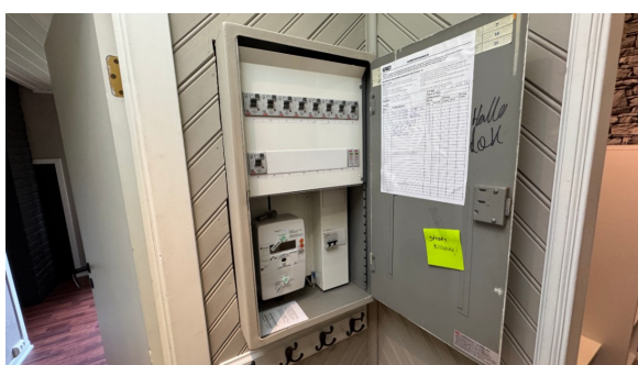
Kontroll av el-skap og kursfortegnelse.
