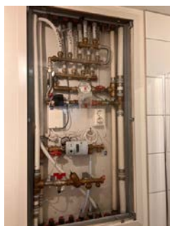
Fordelerskap for vannrør/vannvarme.
