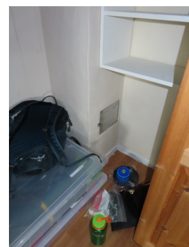
Sotluke i kjeller - det ses å mangle ubrennbar plate til gulv samt ubrennbar plate/brannmur til vegg.
