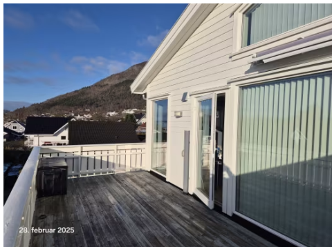
Oversiktsbilde av balkongen. Terrassebord trenger vedlikehold.
