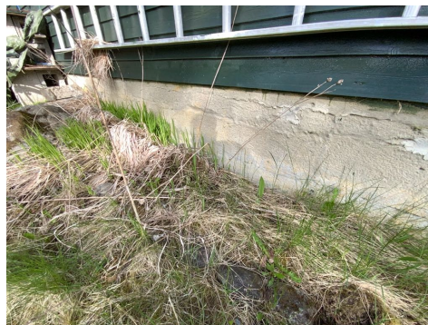
Det er påvist sprekker i murte/pussede fasader.
