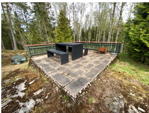
Noe skjevheter i fundamenter.
