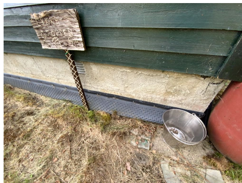
Det er påvist sprekker i murte/pussede fasader.
