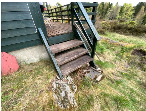
Trapp bør utbedres.
