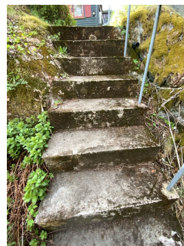
Trapper med behov for vedlikehold.
