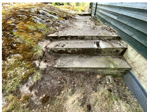
Trapper med behov for vedlikehold.
