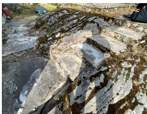
Trapper med behov for vedlikehold.
