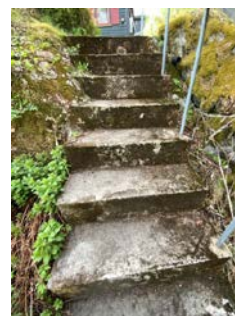
Trapper med behov for vedlikehold.
