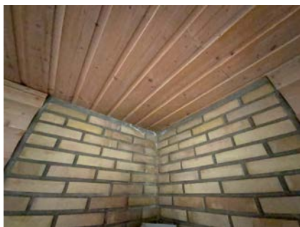
Noe synlig saltutslag på pipevegg.
