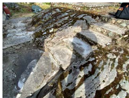
Trapper med behov for vedlikehold.
