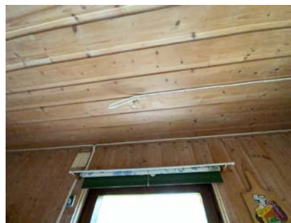
Ledning til lampe bør fastmonteres og isoleres.
