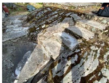
Trapper med behov for vedlikehold.
