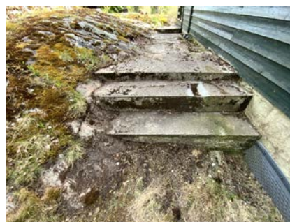
Trapper med behov for vedlikehold.
