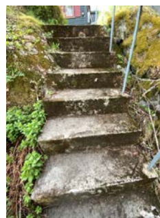
Trapper med behov for vedlikehold.
