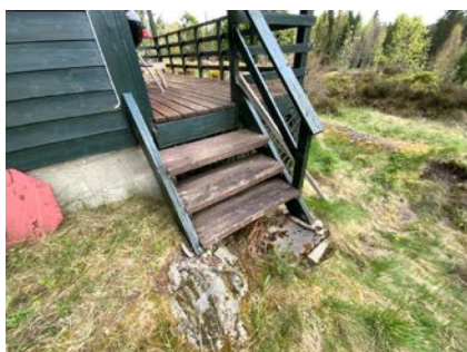
Trapp bør utbedres.
