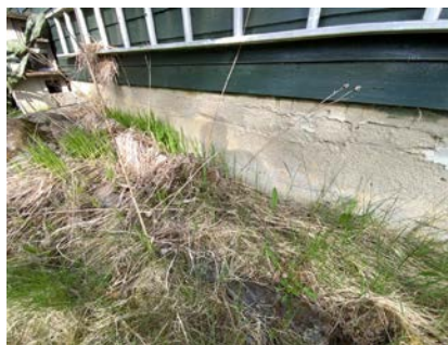
Det er påvist sprekker i murte/pussede fasader.
