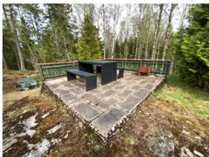
Noe skjevheter i fundamenter.
