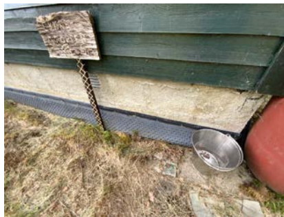
Det er påvist sprekker i murte/pussede fasader.
