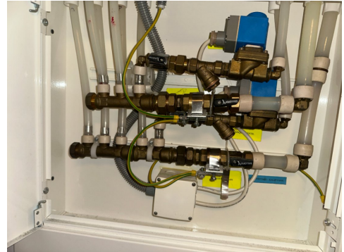
Stoppekraner plassert på bad
