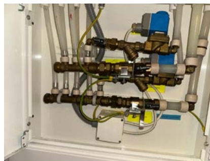
Stoppekraner plassert på bad
