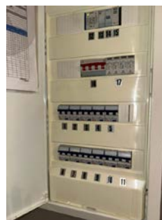
Sikringsskap med automatsikringer.
