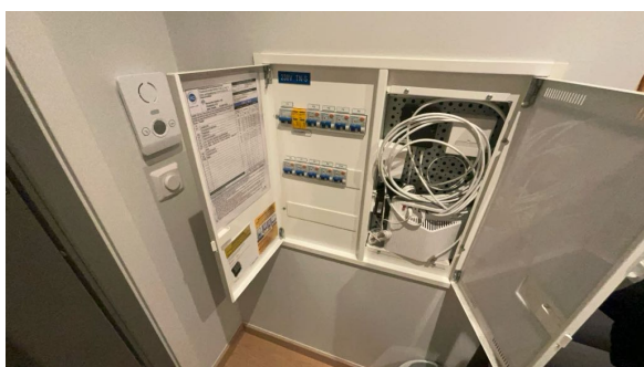
Sikringskap plassert i entre/gang.
