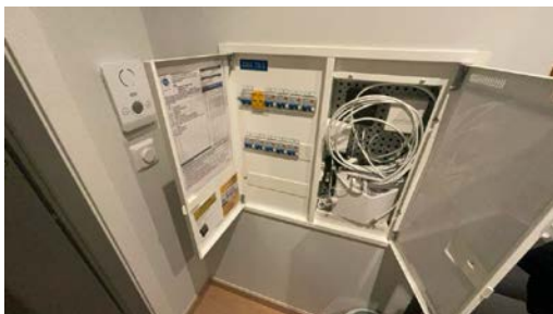
Sikringskap plassert i entre/gang.
