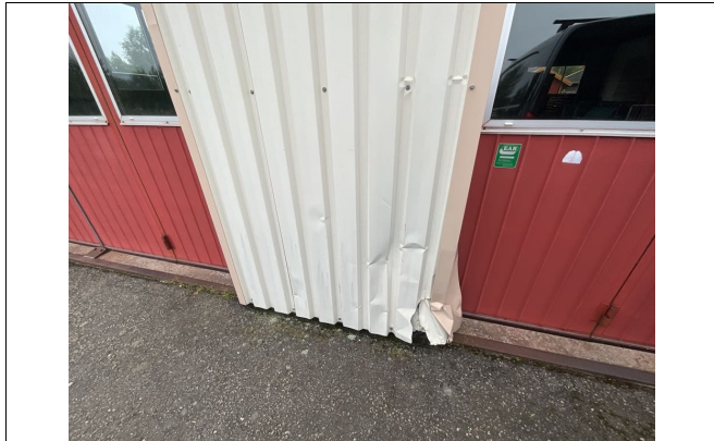
Bilde fra garasjen. Skade ved ene porten.
