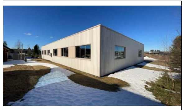
Bilde av garasjen. Påregnelig med generelt vedlikehold.
