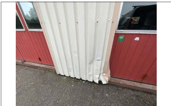
Bilde fra garasjen. Skade ved ene porten.
