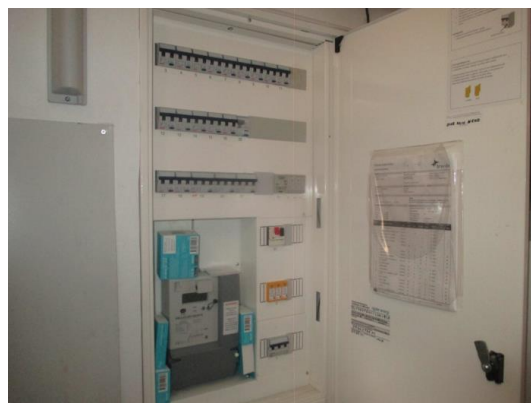
Sikringsskapet er plassert på tekniskrom.
