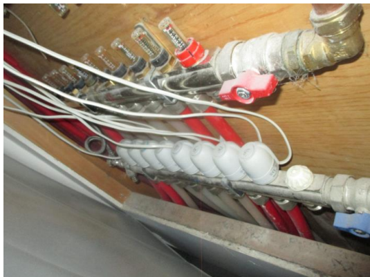
Fordelinger av gulvvarme i skap på tekniskrom.
