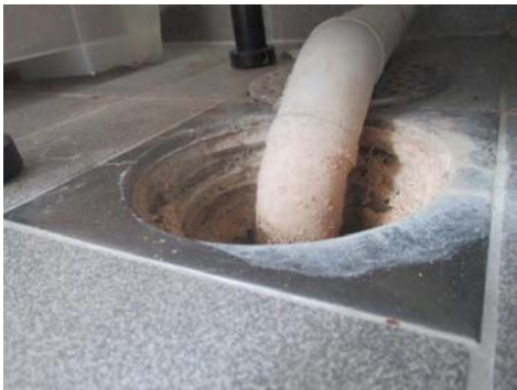
Sluk under innredningen.
