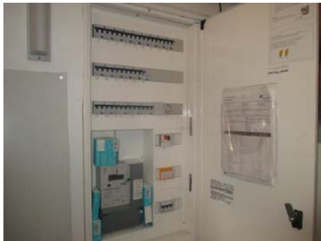
Sikringsskapet er plassert på tekniskrom.
