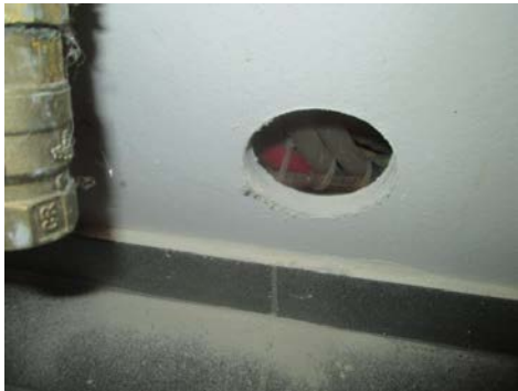
Hulltaking i fra tekniskrom/bod.
