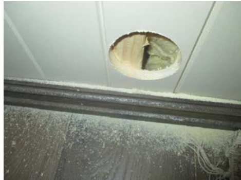
Hulltaking i fra garderoberom.
