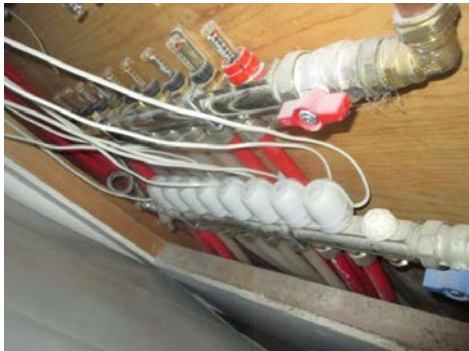
Fordelinger av gulvvarme i skap på tekniskrom.
