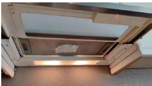
Funksjonstest av ventilator.
