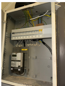
Sikringsskap med automatsikringer.
