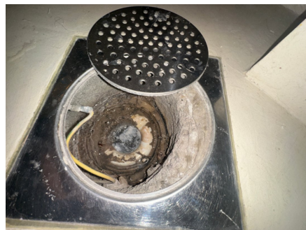
Hovedsluk plassert ved servant
