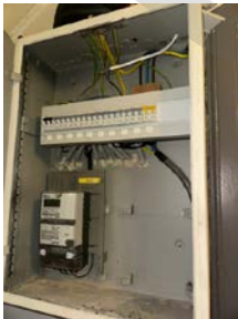
Sikringsskap med automatsikringer.
