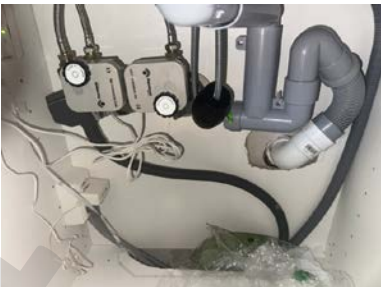
Rørøpplagg i kjøkkenbenk med Waterguard
