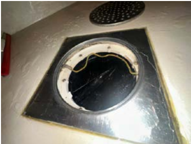
Hjelpesluk plassert i dusjsone
