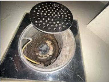
Hovedsluk plassert ved servant
