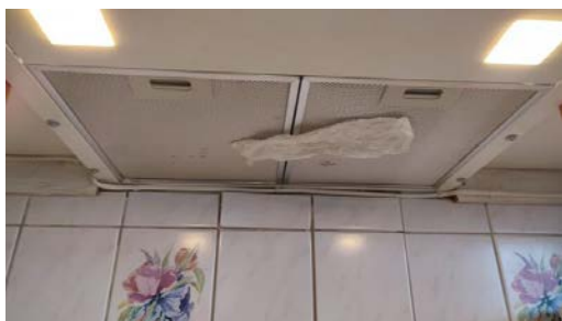
Funksjonstest av ventilator.
