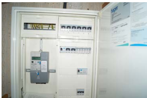
Sikringsskap på loft
