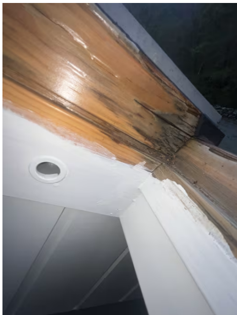
Takvindu har fuktmerker/slitasje.
