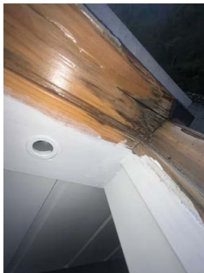
Takvindu har fuktmerker/slitasje.
