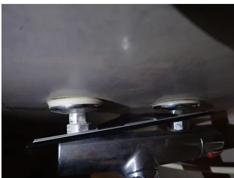
Utette klemringer ved dusjbatteri.
