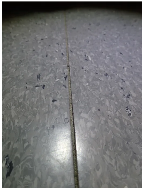
Ingen sveising/fuge i beleggskjøt.
