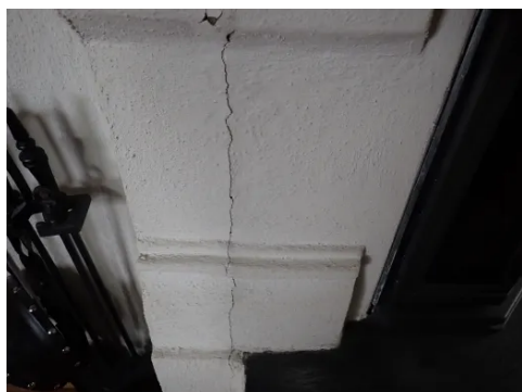
Oppsprekking mellom murte deler på peis/brannmur.
