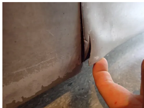
Fuktskade i våtromsplate.
