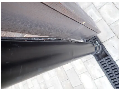
Frostspreng i nedløpsrør.
