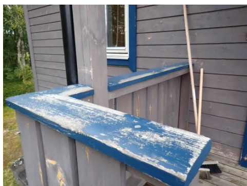
Slitasje i overflaten.
