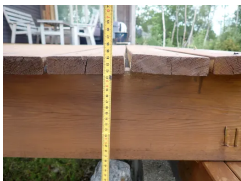
Mer enn 50 cm ned til terreng og manglende rekkverk.
