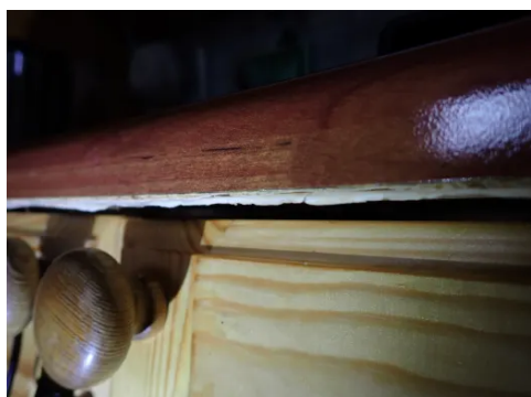
Svelling/fuktskade oppunder benkeplate.
