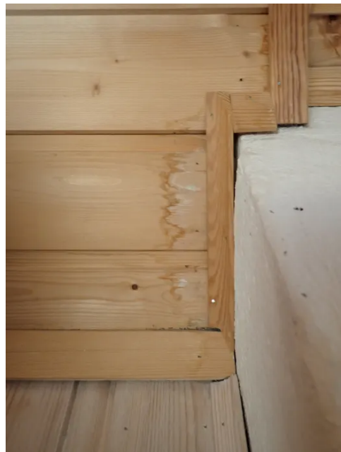
Fuktmerker ved pipegjennomføring i innvendig tak.
