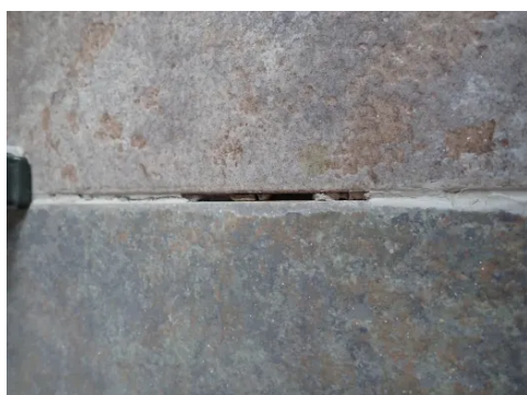
Løsnet flis/skadet flisfuge ved ovnen i 2. etasje.
