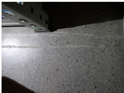
Sprekker/utetthet i beleggsjøt.
