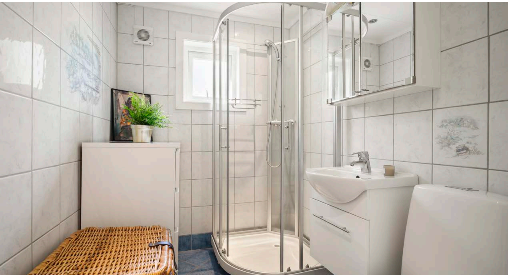
Lyst baderom med påstøpt gulv med antatt varmekabler, fliser på gulv og vegger, downlights i himlingen og mekanisk avtrekksvifte.
