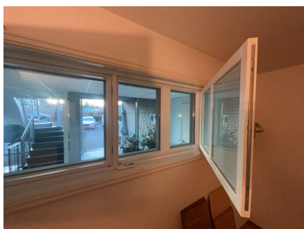
Vinduer soverom kan ikke åpnes
