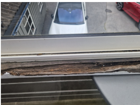
Råteskade i rekkverk
