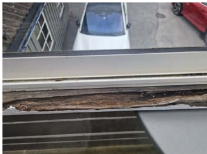
Råteskade i rekkverk
