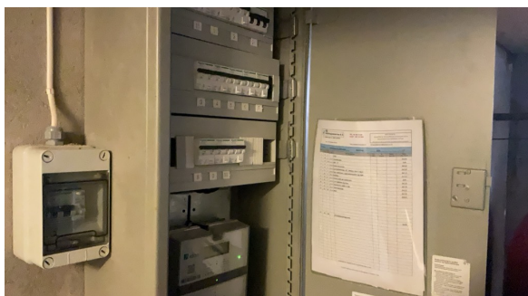
Sikringsskap plassert på teknisk rom.
