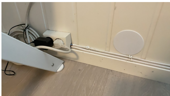
Manglende håndverksmessig utførelse.
