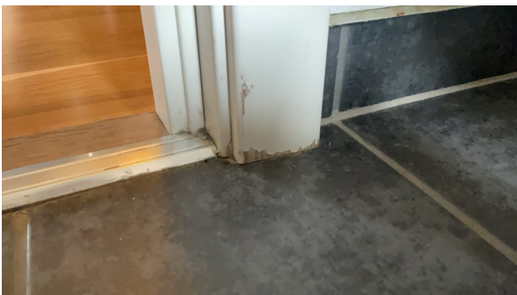
Fuktopptrekk i omramning til dør.
