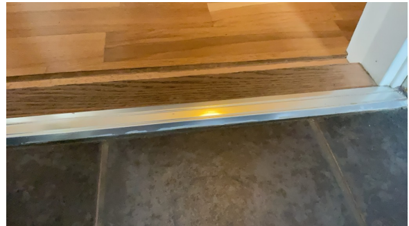
Ingen oppbrett av membran ved terskel.
