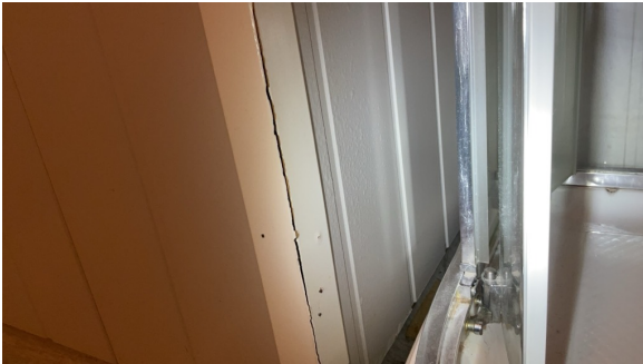
Svelling/fuktmerker på vegg.
