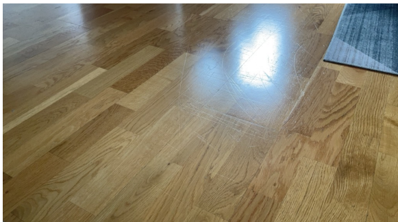
Hakk/slitasje på parkett i stue
