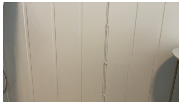
Manglende håndverksmessig utførelse.
