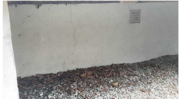
Sprekker i grunnmur.
