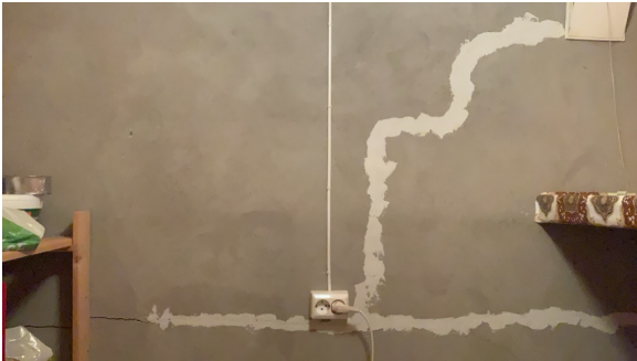
Setningsskader ble registrert på grunnmur.
