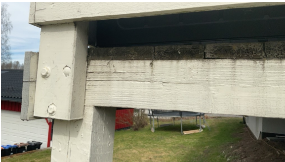
Råteskader i bærende konstruksjoner.
