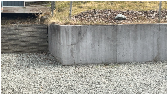
Sprekk i støttemur.
