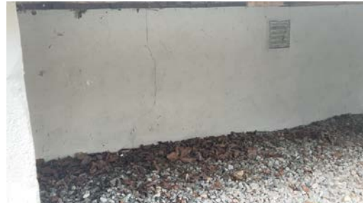
Sprekker i grunnmur.
