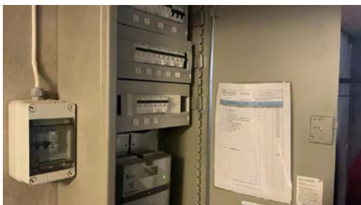
Sikringsskap plassert på teknisk rom.
