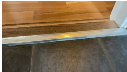
Ingen oppbrett av membran ved terskel.
