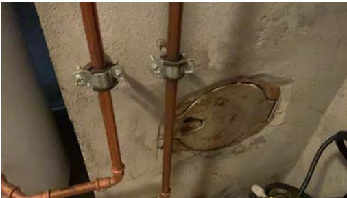
Sotluke plassert i teknisk rom i kjeller.
