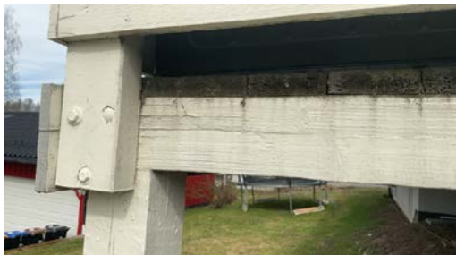
Råteskader i bærende konstruksjoner.
