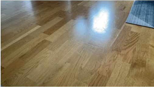
Hakk/slitasje på parkett i stue
