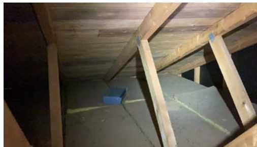
Lufting mot raft er delvis dekket av isolasjon.
