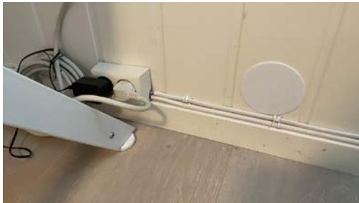
Manglende håndverksmessig utførelse.
