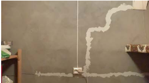
Setningsskader ble registrert på grunnmur.
