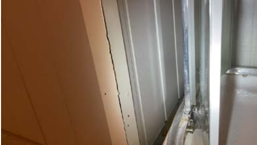
Svelling/fuktmerker på vegg.
