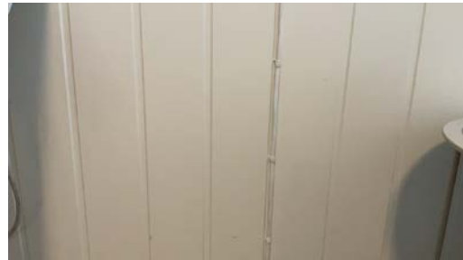
Manglende håndverksmessig utførelse.
