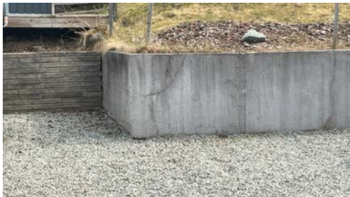
Sprekk i støttemur.
