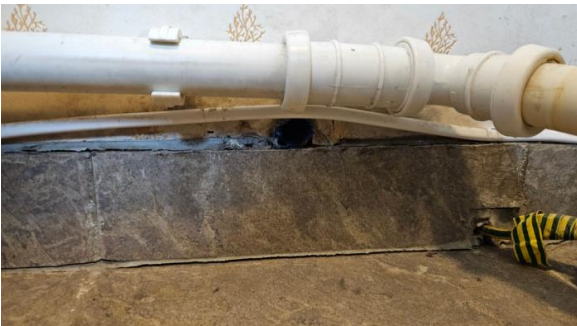
Mangler siklemikk på avrenning fra vannskap.
