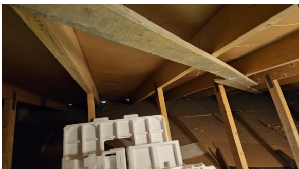
Luftespalter er presset opp mot undertak.
