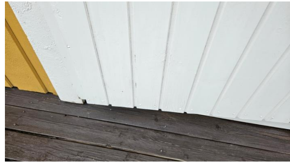
Terrassedører er noe værslitte.
