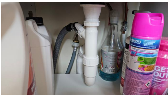
Kontroll av servantskap.
