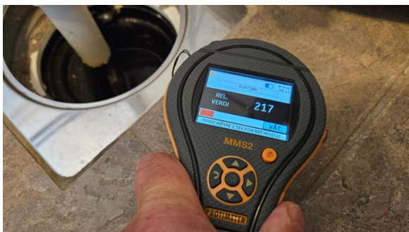
Kontroll av fuktmåling, noe forhøyet verdier ble registrert.
