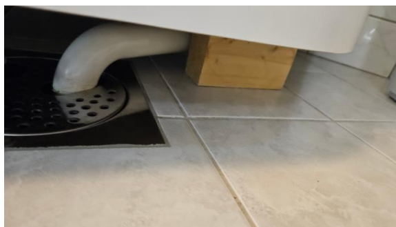
Det er plassert klosser under dusjkabinett, dette er trolig på grunn av at fot til dusjkabinett er rett over slukrist.
