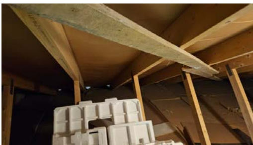
Luftespalter er presset opp mot undertak.
