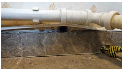
Mangler siklemikk på avrenning fra vannskap.
