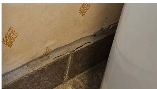
Det er bobler i tapet ved varmtvannsbereder.
