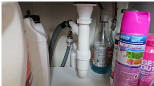
Kontroll av servantskap.
