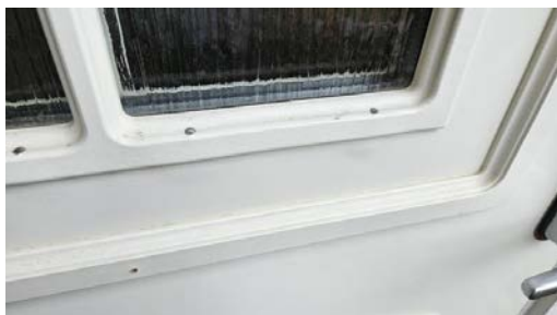
Fuktsvell i inngangsdør.
