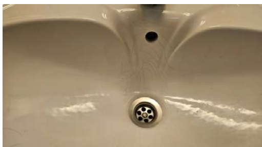
Servant er krakelert.
