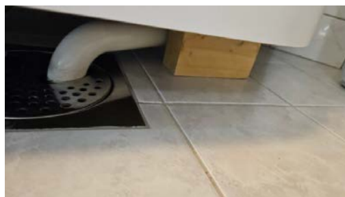
Det er plassert klosser under dusjkabinett, dette er trolig på grunn av at fot til dusjkabinett er rett over slukrist.
