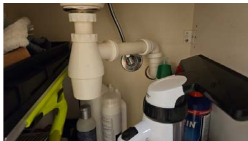
Det er ikke tettet rundt avløpsrør i servantskap.
