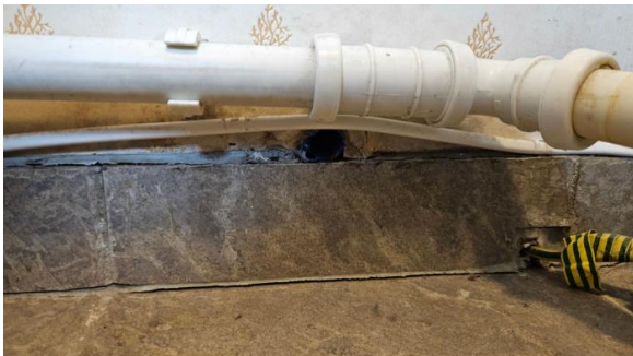
Mangler siklemikk på avrenning fra vannskap.
