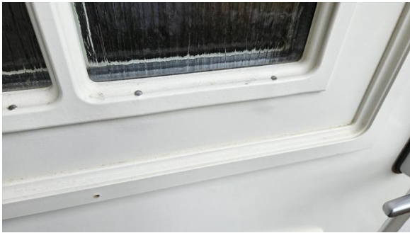
Fuktsvell i inngangsdør.
