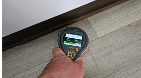
Det ble ved befaring fuktmålt i benkeskap og fremfor oppvaskmaskin, ingen forhøyede verdier ble registrert.
