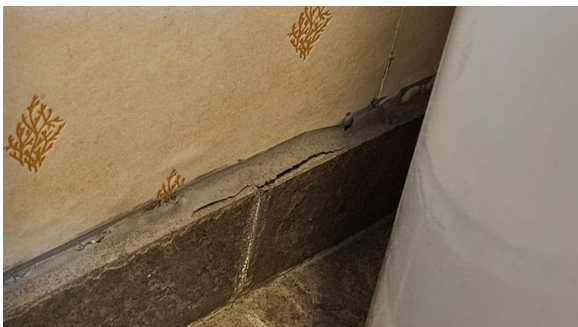
Det er bobler i tapet ved varmtvannsbereder.
