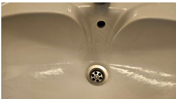
Servant er krakelert.
