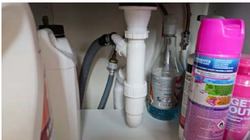
Kontroll av servantskap.
