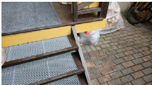
Mangler rekkverk på trapp.
