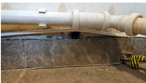
Mangler siklemikk på avrenning fra vannskap.
