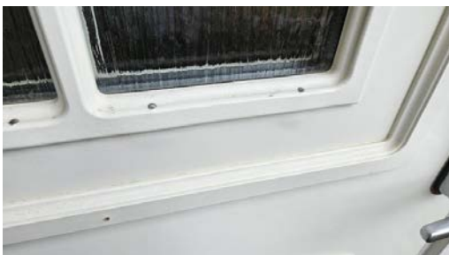
Fuktsvell i inngangsdør.
