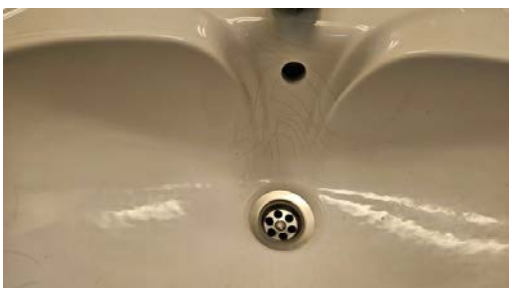
Servant er krakelert.
