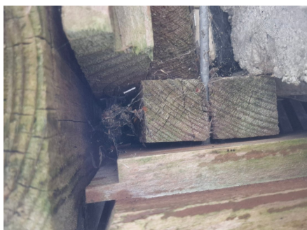
Mangler musesperre i hjørnekasse.
