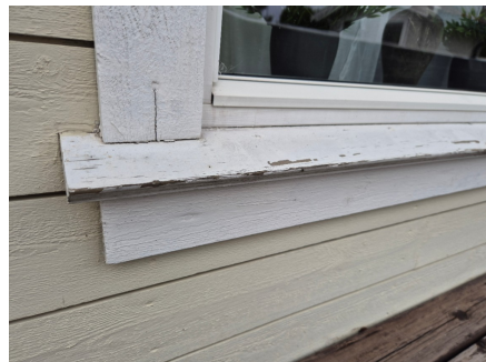
Mangler beslag i underkant av vindu.
