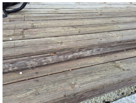
Råte i terrassebord.
