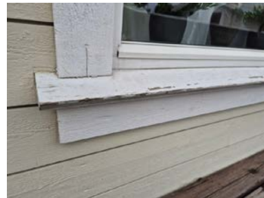
Mangler beslag i underkant av vindu.
