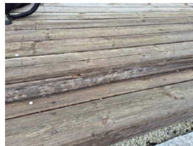
Råte i terrassebord.
